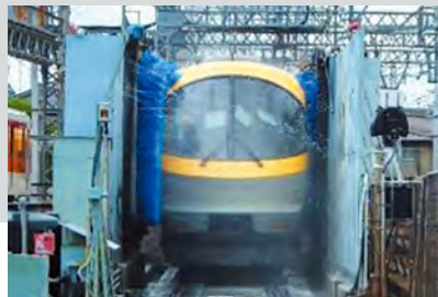
車体洗浄装置
